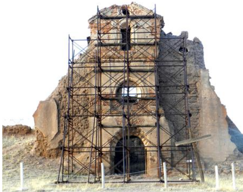
Estado actual de la iglesia de Cocóspera, vista exterior donde se observan los muros de adobe, contrafuertes de piedra y restos de la fachada principal apuntalada; el deterioro de la fábrica es notorio y peor aún que no se han tomado las medidas definitivas para su conservación. (Fotografía del autor, febrero de 2012)
