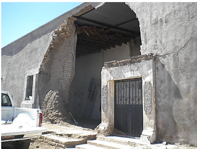
En la iglesia de la misión de Ónavas localizada en la Pimería Baja se observan actualmente deterioros irreversibles y alteraciones a la fábrica de la iglesia (Fotografía Centro INAH Sonora, Ónavas, noviembre de 2011)
