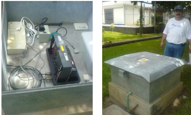
Figura 55. Estación acelerográfica de la facultad de Ingeniería de la UNACH, la cual data de 1986 y que captó el sismo del 20 de octubre de 1995.
