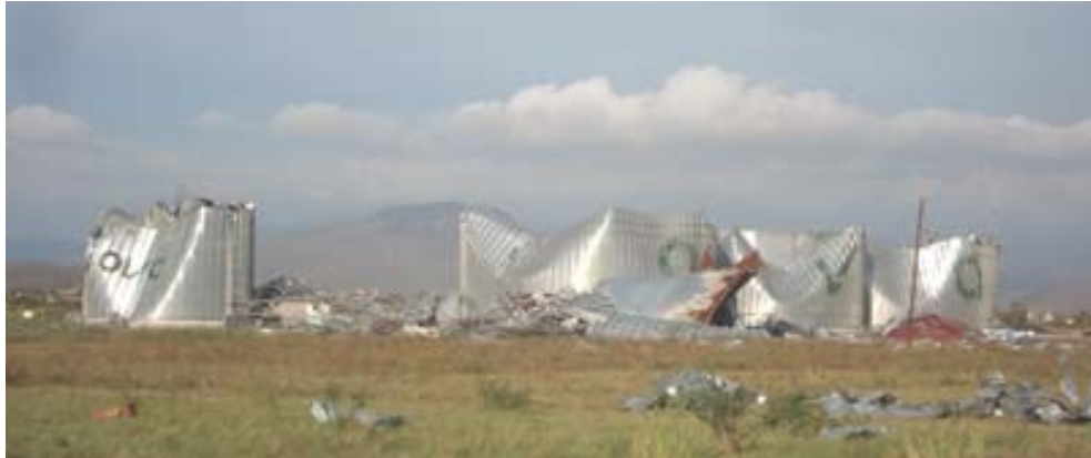
Figura 2.9 Silos dañados por el viento del huracán Lane (2006) en La Cruz de Elota, Sinaloa
